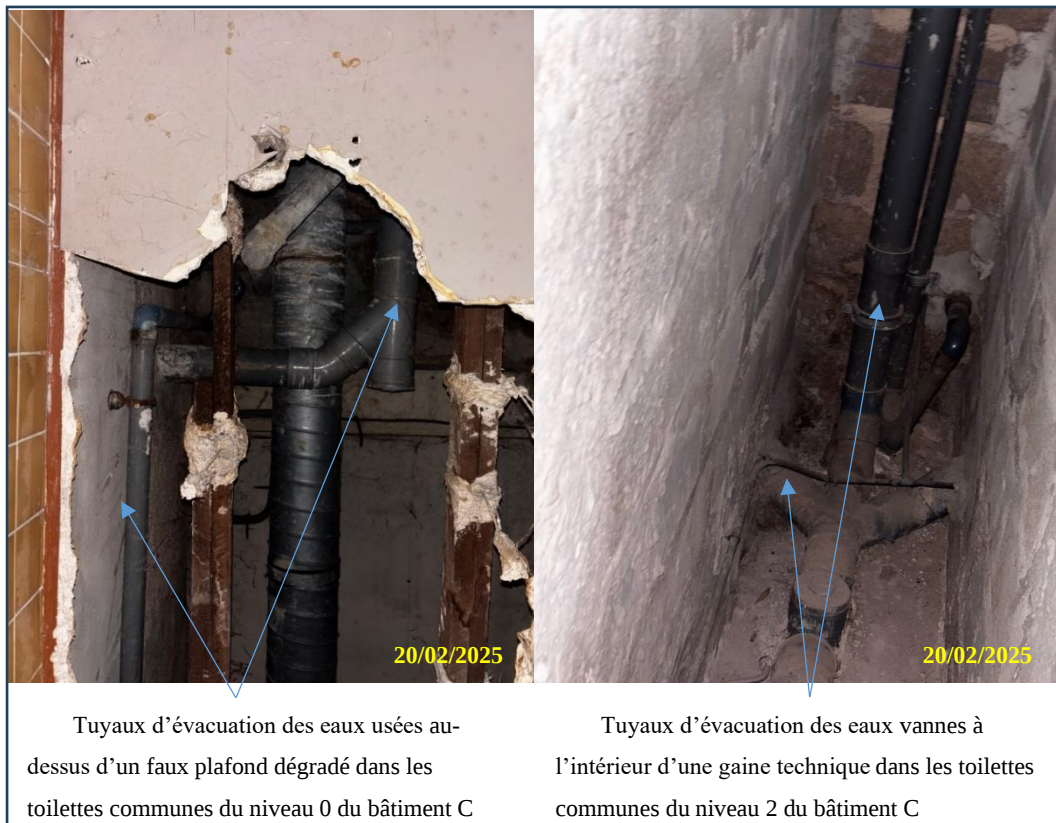
Figure 19: L'intérieur d'une gaine technique et d'un faux plafond Source : (Notre étude, 2025)
